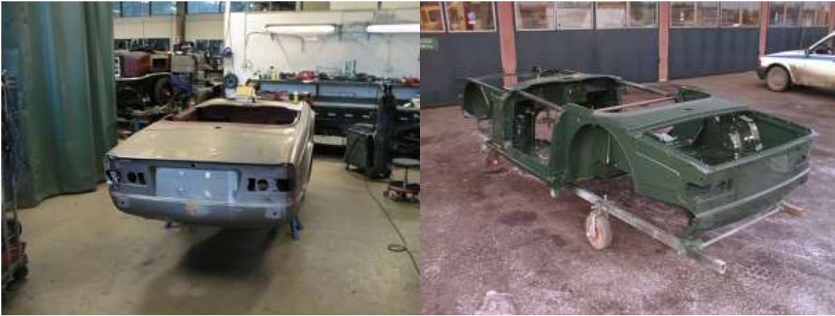
Muut vauriot korista korjattiin täysin käsityönä. Kori maalattiin osina, ovet ja luukut erillään.
